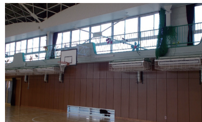
令和6年度に空調設備が整備された 鎌ヶ谷小学校体育館
